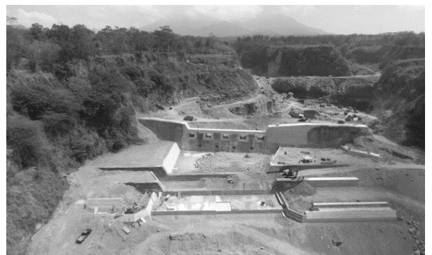
Gambar 7. Sabo dam GE-D5 dengan penambahan lantai apron
