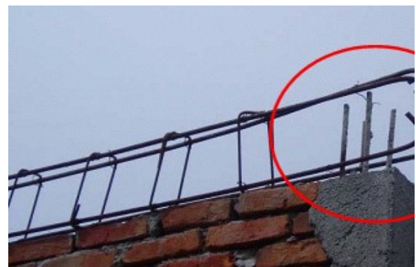
Gambar 4. Detail sambungan tulangan balok-ke-kolom yang salah (Boen, 2006)
