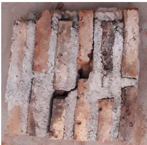
Gambar 8. Retakan batu bata uji diagonal
