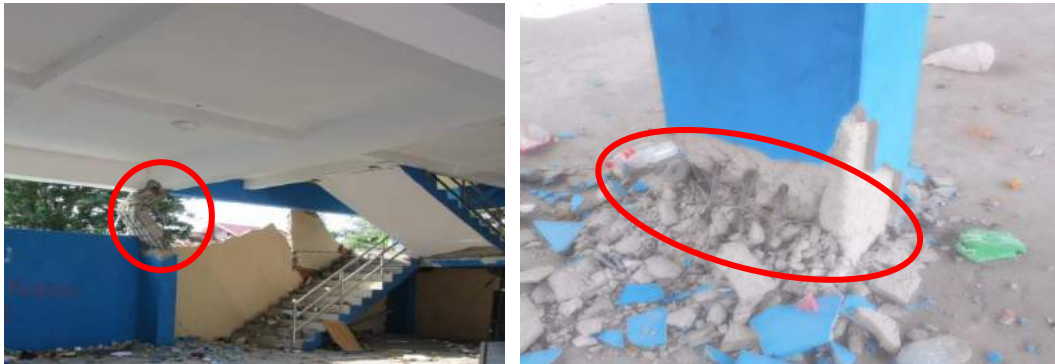
Gambar 1.3 Kerusakan kolom lantai satu pada gedung Dinas Pemadam Kebakaran Kota Palu
