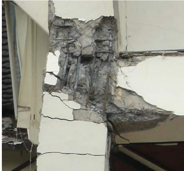
Gambar 1. Kegagalan geser sambungan balok-kolom beton bertulang
