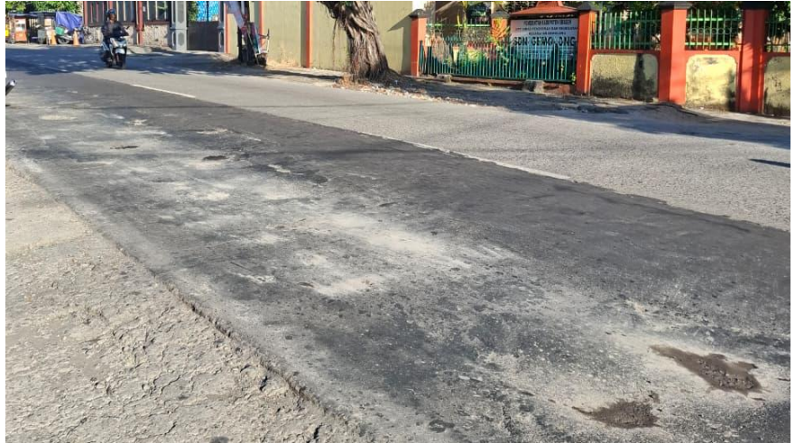
Gambar 2.1 Kondisi Ruas Jalan Sukowati Gemolong Sragen (Sumber: Dokumentasi Pribadi, 2026)
