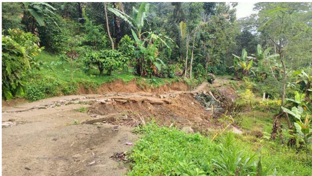
Lampiran 3. Kondisi Longsoran Badan Jalan.
